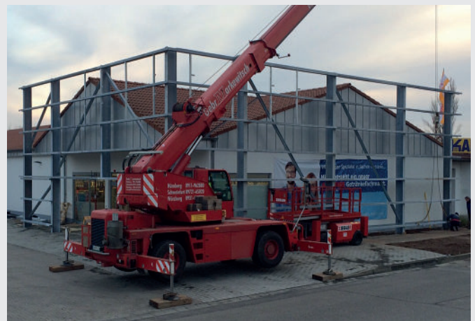
SAGASSER Getränkefachmarkt in Haßfurt vor und nach der Installation der unverwechselbaren SAGASSER-Fassade
